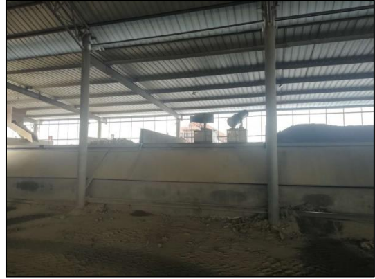
照片 14 配料间喷雾洒水装置
