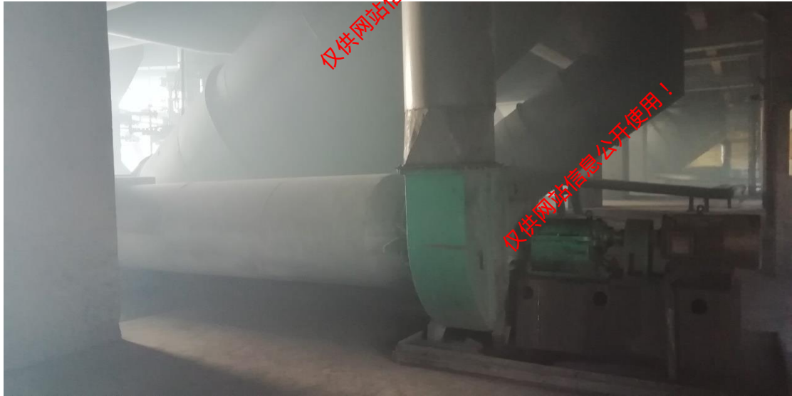
照片 20 主厂房风机独立减震基础
