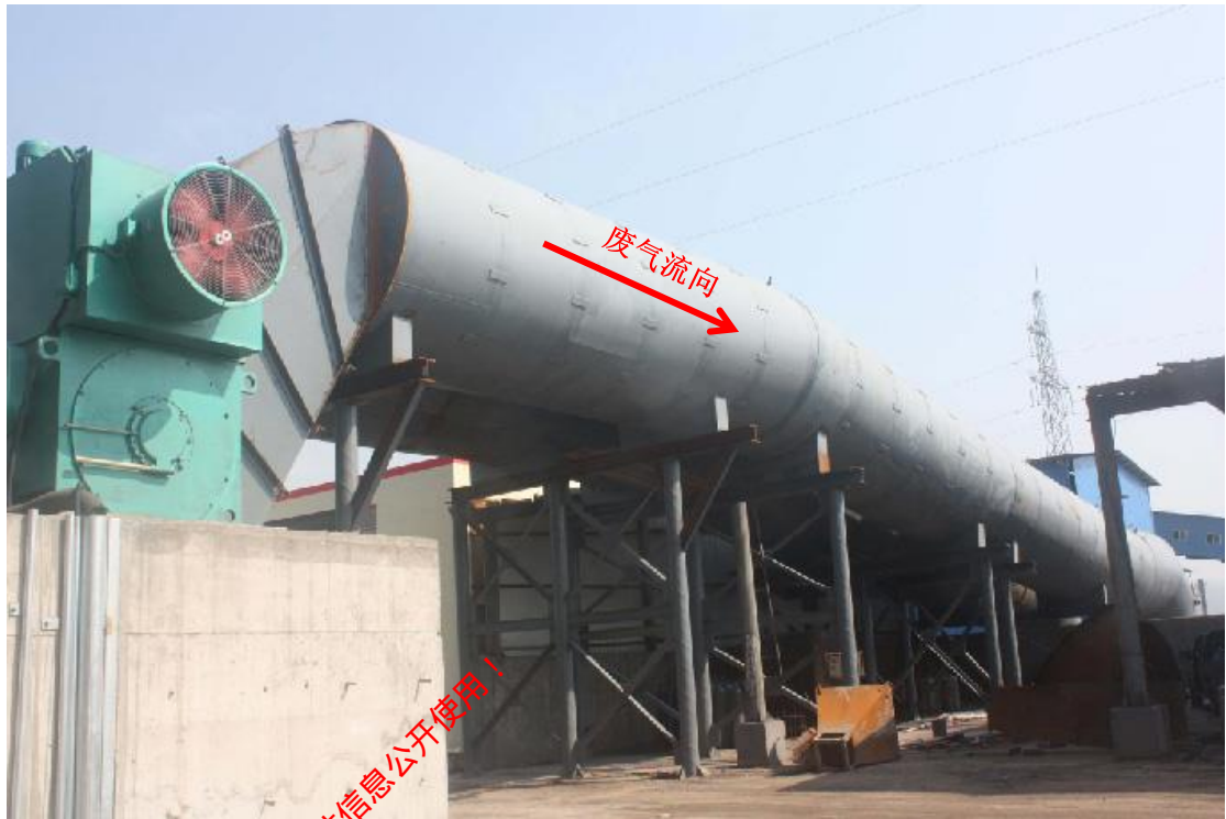
照片 3 废气输送管道
