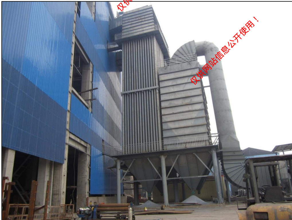
照片 2 废气空冷器及旋风除尘器
