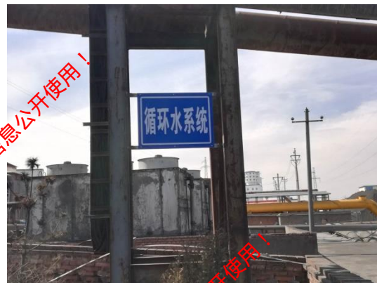
照片 28 循环水系统标志
