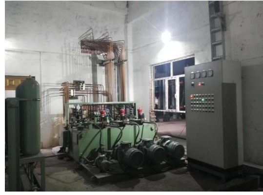
照片 22 机泵置于地下室内
