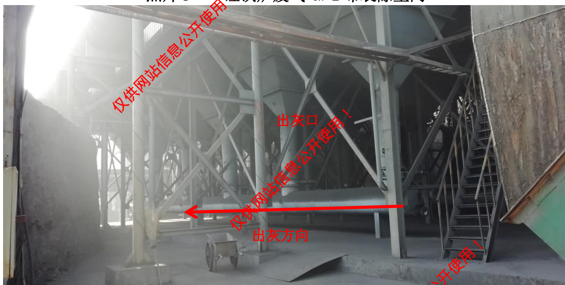
照片 6 硅铁炉废气 3#布袋除尘间
