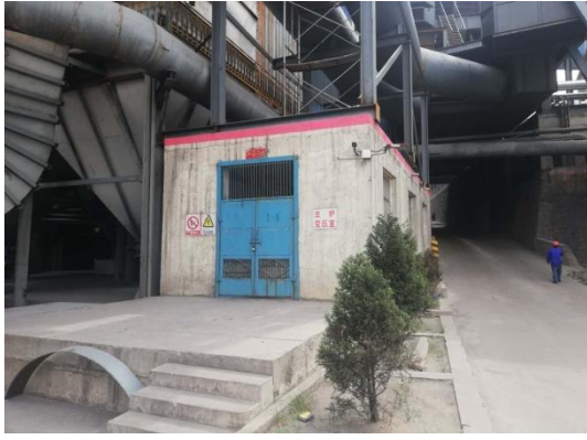
照片 21 变压器置于室内
