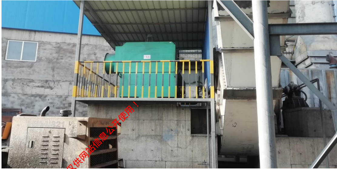
照片 19 硅铁炉主抽气风机独立减震基础（1#风机）
